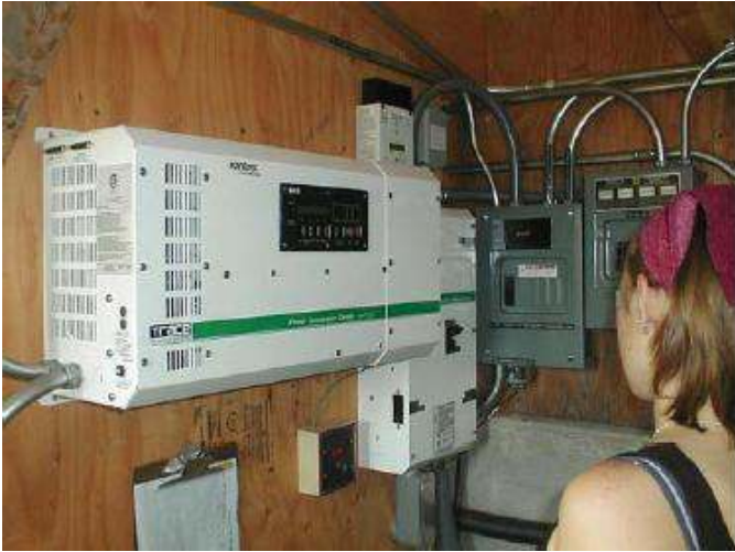
DC 発電での蓄電池以外の制御器類です。ソーラーに似ていますが、水力の場合ダミーロードが必要です。
